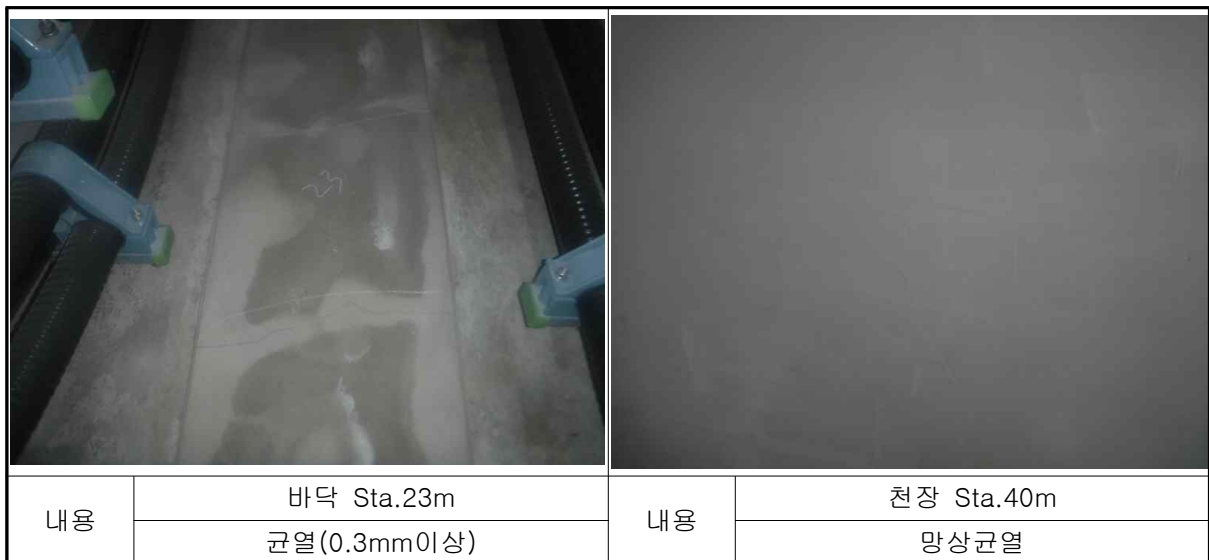
【사진 13.2】 고양분기 전력구 주요 손상
